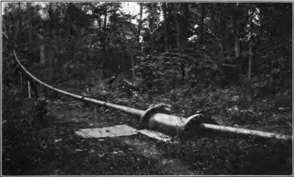
FIG. 6. KETTRING SEPARATOR IN PIPE LINE.
